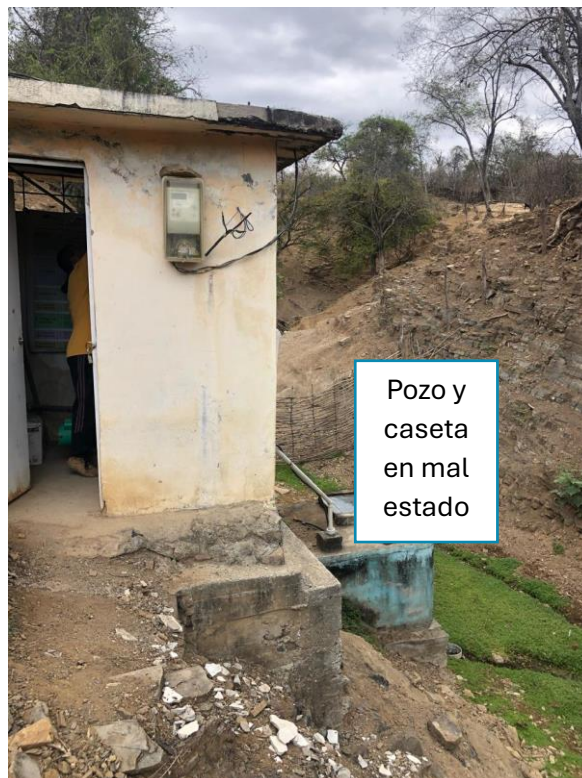
Ilustración 2.43 Situación actual del sistema de agua de Totumitos
