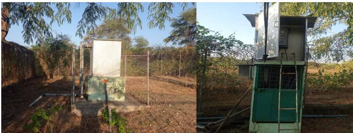
Ilustración 2.35 Caseta de bombeo sistema de agua cabecera parroquial Limones
