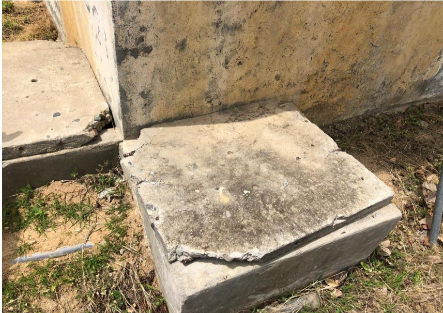
Ilustración 2.42 Situación actual del sistema de agua de Totumitos
